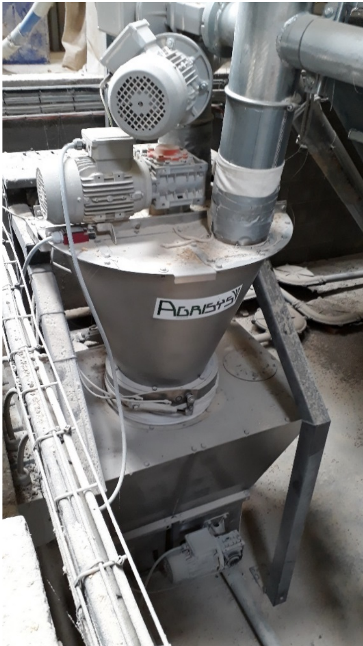
Billede 1. Foderanlæg til fodring på enkelt foderautomat niveau. Billedet viser portionsvægten og optagestation nedenunder. I foderladen laves én portion ad gangen, og denne køres ud til de foderautomater, hvor der efterspørges foder. Der er én sensor og én ventil monteret på hver foderautomat.
